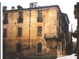
Il degrado di Palazzo Samone
